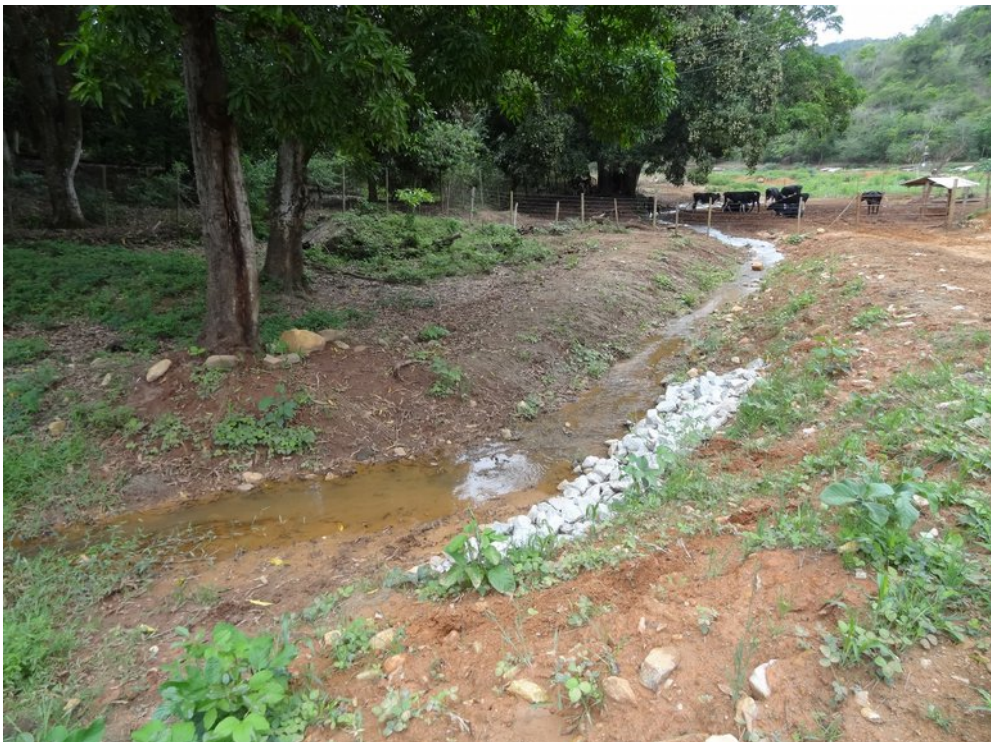
NTC07 d: Detalhe para o enrocamento. Área de pisoteio de animais (bovinos).
