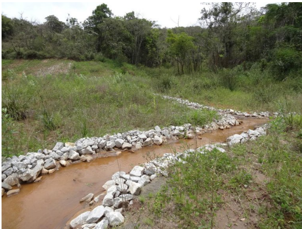
NTG 16 a: Planície de inundação reconformada, no terço a jusante, com regeneração vegetal, retaludamento das margens do curso d'água e obras de contenção considerados regulares.
