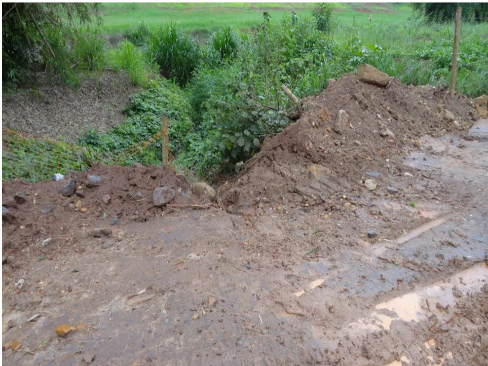
NTG05 c: Afundamento da via de acesso e detalhe para o mix de espécies
