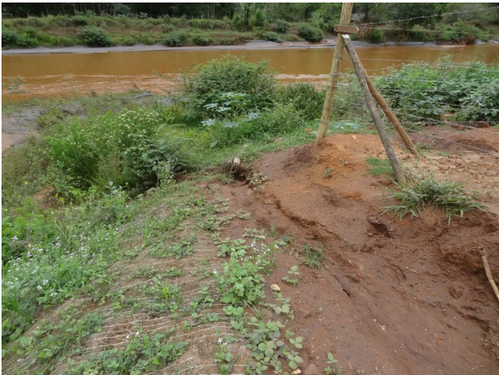
NTC07 b: Detalhe para falhas de germinação do mix e processos erosivos.
