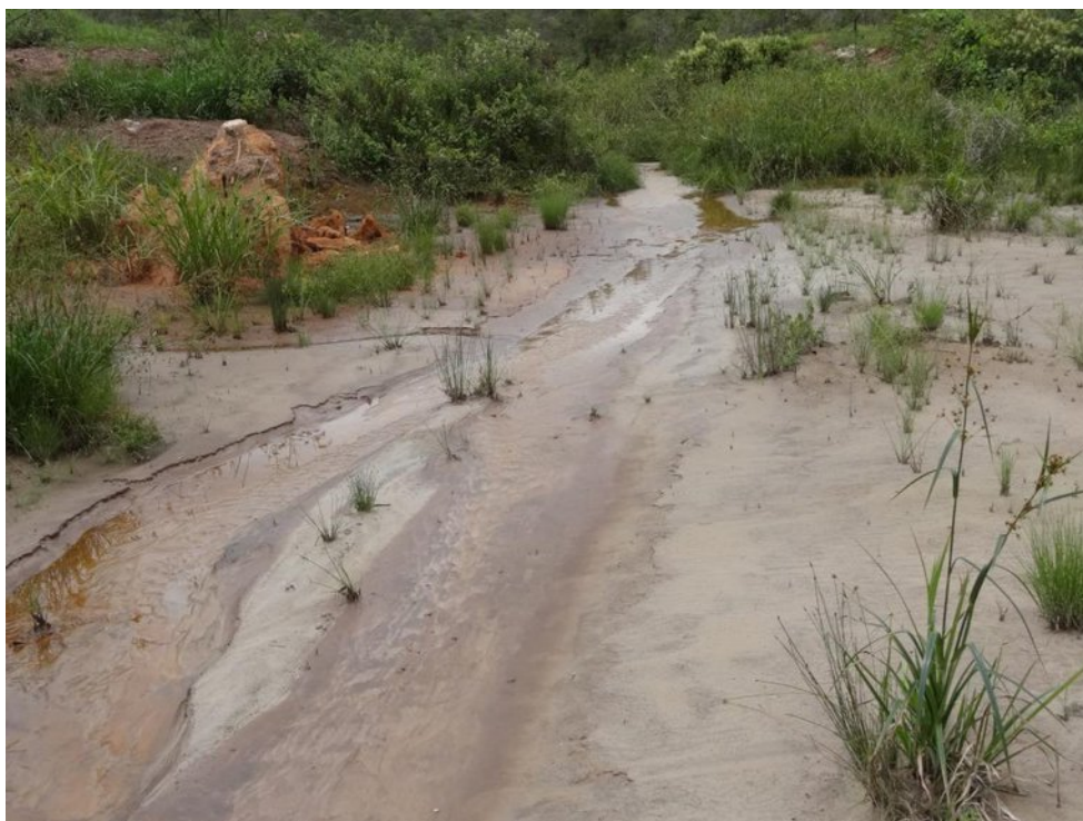
NTG 01 c: Processos de erosão laminar e com ravinas profundas por toda área.
