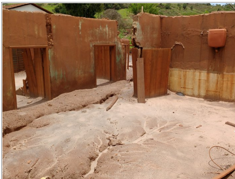
NTG 02 b: Detalhes de camada de rejeito e processo erosivo no contexto do Distrito de Paracatu de Baixo.
