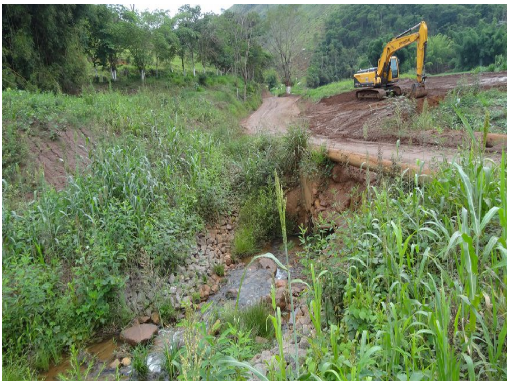
NTG06 d: Estrada de acesso à área afetada. Detalhe para ações emergenciais com uso de solo de empréstimo.
