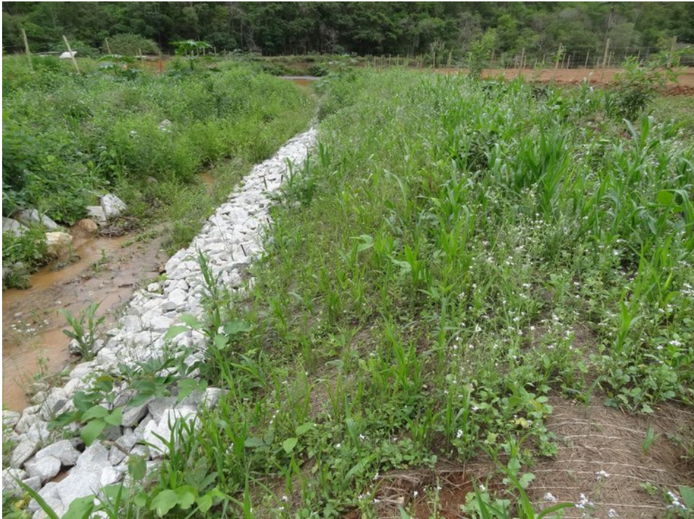
NTC07 a: Detalhe para o enrocamento na calha do tributário, biomanta e mix de espécies.
