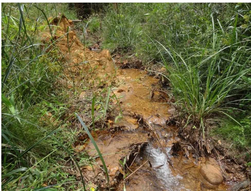
NTG 16 b: A área afetada à montante, com processos de erosão laminar e ravinas profundas resultando no desmoronamentos das margens e dos taludes.
